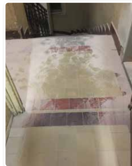
Vysoká prašnost vlivem neohlášených stavebních prací
